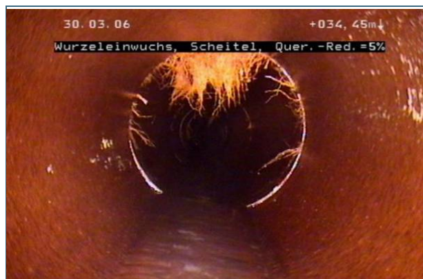
Abb. 3: Wurzeln, die in die Abwasserleitung einwachsen, müssen entfernt werden, sonst verstopft die Leitung. In diesem Beispiel ist die Sanierungspriorität mittel bis hoch.
